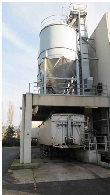
Photo 13 : Trémie de stockage des boues séchées et benne de transport
